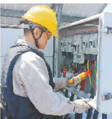
运维人员巡检设备
