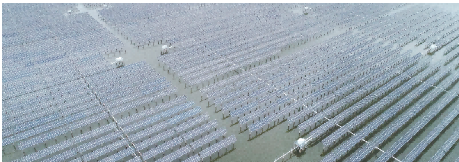
辽宁东港小甸子光伏电站
